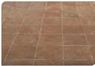
Bề mặt bê tông chưa đạt
