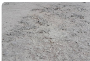
Bề mặt bê tông chưa đạt
