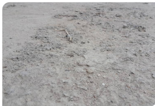
Bề mặt bê tông chưa đạt
