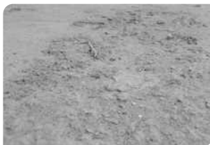
Bề mặt bê tông chưa đạt
