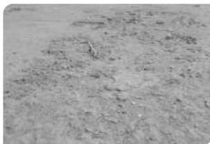
Bề mặt bê tông chưa đạt
