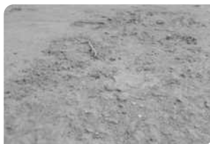
Bề mặt bê tông chưa đạt
