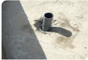
Đục vát quanh cổ ống, chèn xốp hoặc cốp pha bên dưới cổ ống
