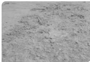
Bề mặt bê tông chưa đạt
