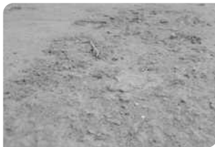
Bề mặt bê tông chưa đạt
