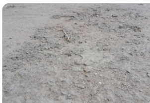
Bề mặt bê tông chưa đạt
