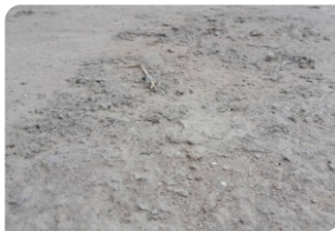
Bề mặt bê tông chưa đạt
