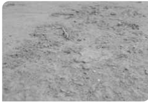
Bề mặt bê tông chưa đạt
