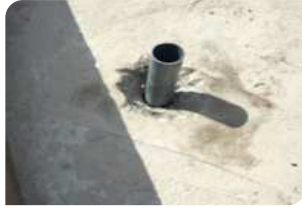
Đục vát quanh cổ ống, chèn xốp hoặc cấp pha bên dưới cổ ống
