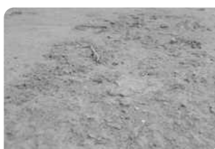
Bề mặt bê tông chưa đạt
