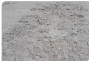
Bề mặt bê tông chưa đạt
