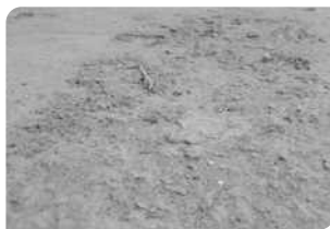
Bề mặt bê tông chưa đạt
