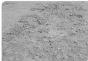
Bề mặt bê tông chưa đạt
