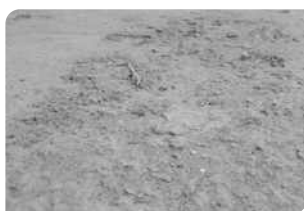
Bề mặt bê tông chưa đạt
