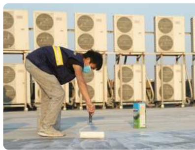
Bước 2: Quét lớp lót Revinex pha với nước (tỷ lệ 1:4). Định mức 0,05 kg/m 2 (vật liệu lót Primer phải được khuấy bằng máy khuấy tốc độ chậm trong vòng 3 phút trước khi thi công...)
