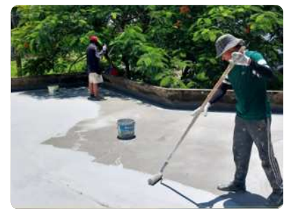
Bước 3: Thi công lớp phủ thứ 1 (pha 5% nước) sau khi lớp lót kết thúc 2 giờ. Định mức: 1,0-1,25 kg/m 2 (vật liệu chính phải được khuấy bằng máy khuấy tốc độ chậm trong vòng 3 phút trước khi thi công...)
